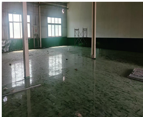
贮存中心内部
