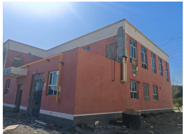
项目区（锅炉房）
